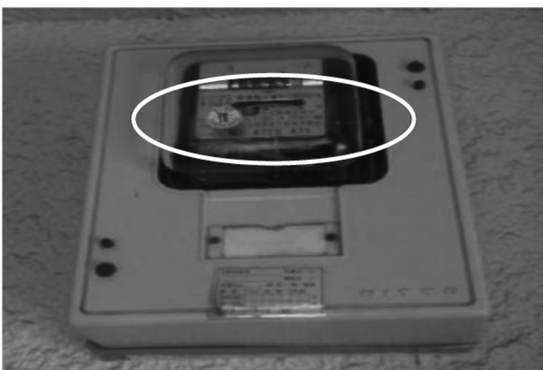
空室率チェックの例～電気メーター
